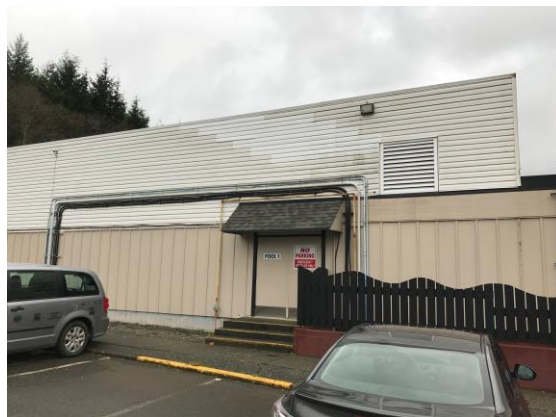
Propane Gas PRV
